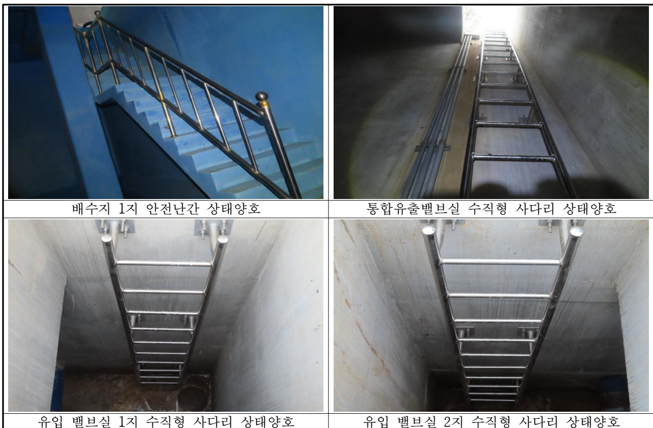
【사진 3.7】 안전시설(점검로) 손상사진
