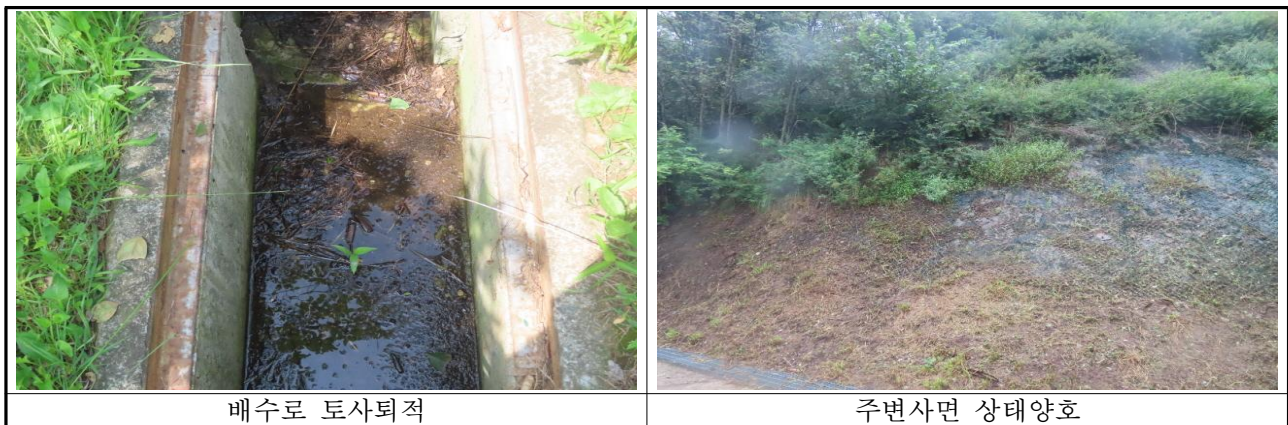
【사진 3.8】 기타 부대시설 손상사진 (계속)
