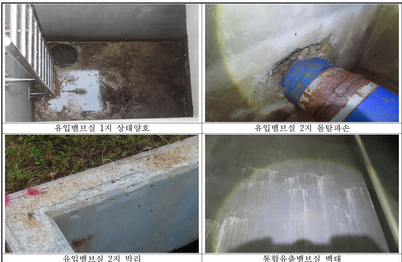
【사진 3.4】 유입·유출 밸브실 손상사진 (계속)
