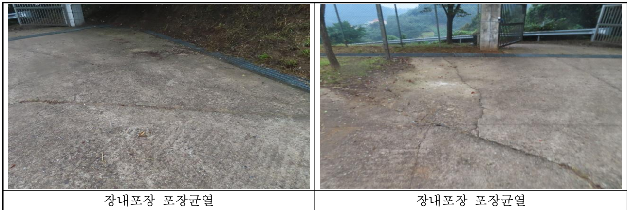
【사진 3.10】 도로포장 손상사진
