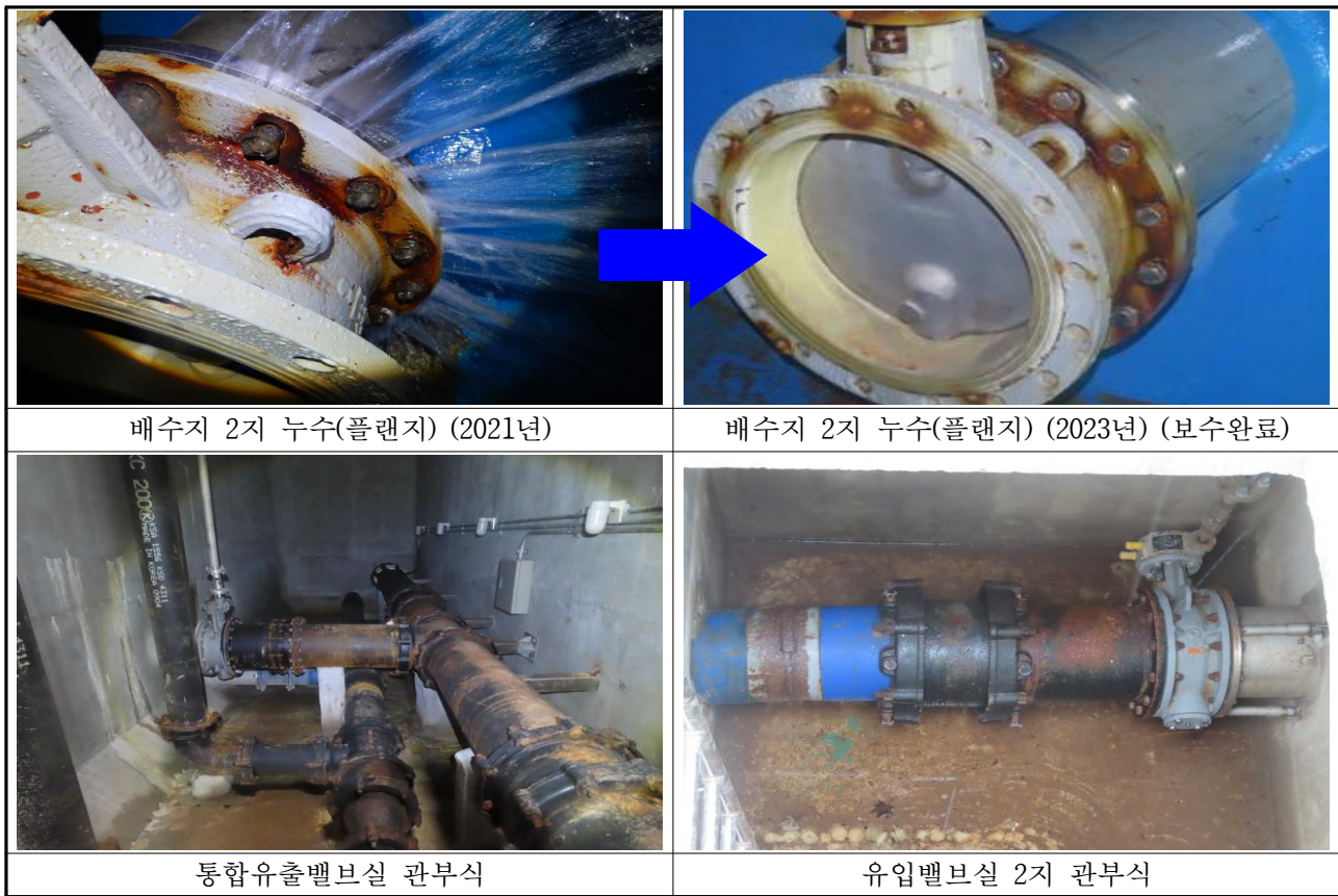
【사진 3.6】기전설비 손상사진
