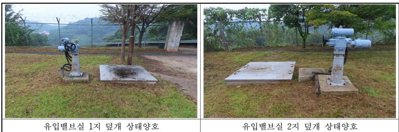
【사진 3.11】 환기구 등의 덮개 손상사진
